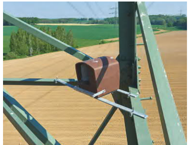
Holzbeton-Turmfalkenkasten als Sonderanbringung nach Genehmigung in einem Elektromasten.
